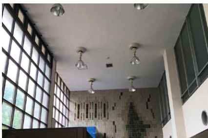
改修前（水銀灯）
