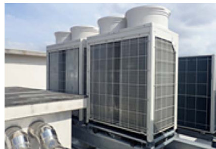
改修後（室外機／高効率）
